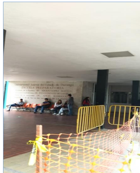
DISTANCIA APROXIMADA DE 15 MT DE RECORRIDO DE CABLEADO PARA ALIMENTACION ELECTRICA.
