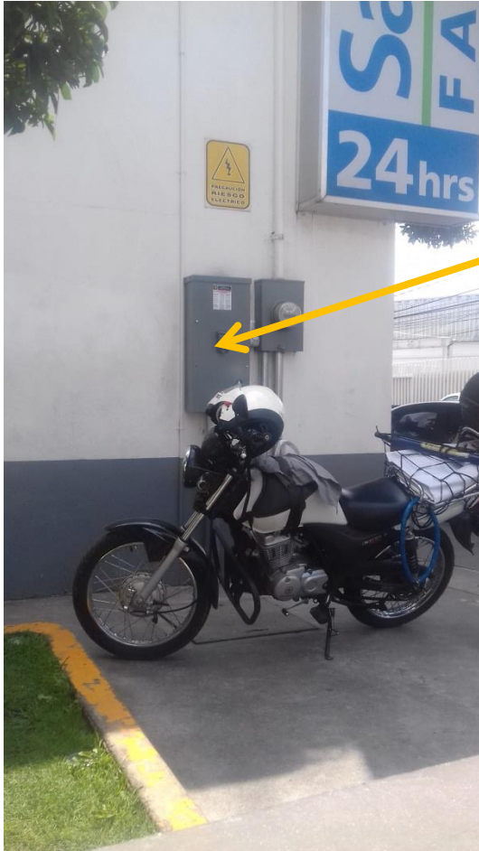
Centro de Carga a T220v para conectar Máquina de Soldar.
