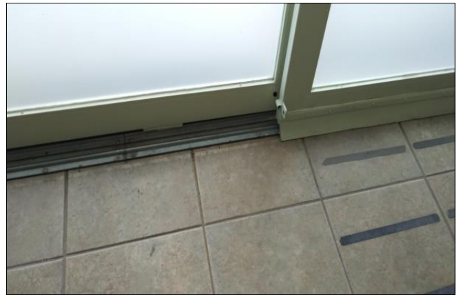
SE DEBERA TENER PRECAUCION EN ACCESO PARA USO DE PATIN POR RIELES INTERIORES EN PUERTA PRINCIPAL
