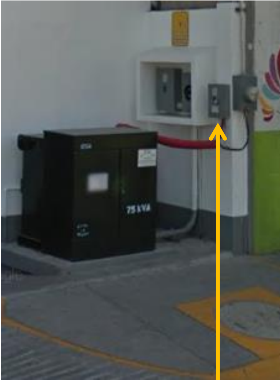
Centro de Carga a T220v para conectar Máquina de Soldar.
