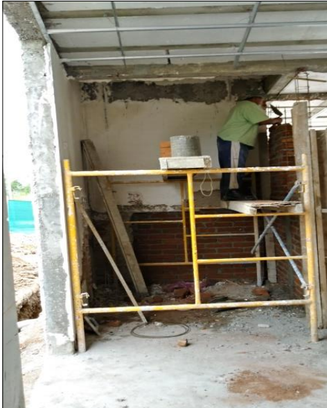
CUBO DE ELEVADOR EN PB. EL CLIENTE ACEPTA QUE AL TENER MUROS DESCUARATOS SE TENDRAN LIGEROS DESCUADRE.
